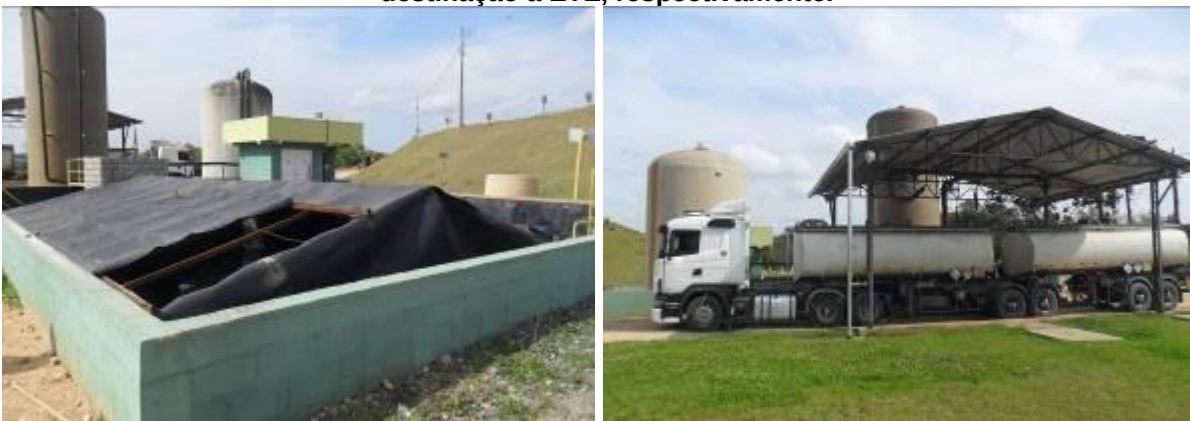
Figura 50: Armazenamento temporário do chorume e caminhão coletor para transporte e destinação à ETE, respectivamente.
