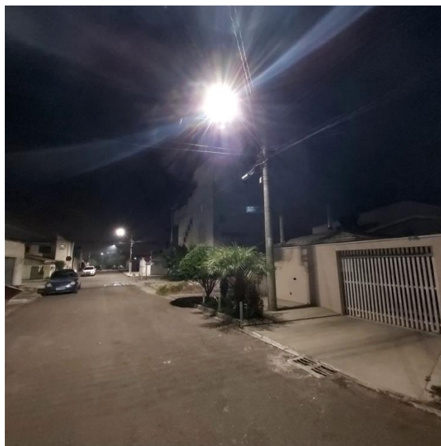
Figura 8 -Ponto de IP na Rua Sebastião Carneiro
