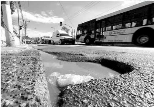
Buraco e esgoto a céu aberto em avenida na zona sul de São Paulo
