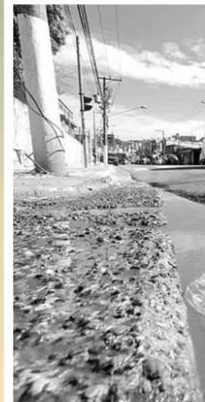
Buraco e esgoto a céu aberto em a
