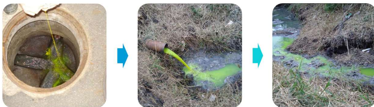
Figura 19: Descarte de esgoto in natura identificado através do despejo de corante biológico em PV da rede de esgoto. Fonte: MARHS.
