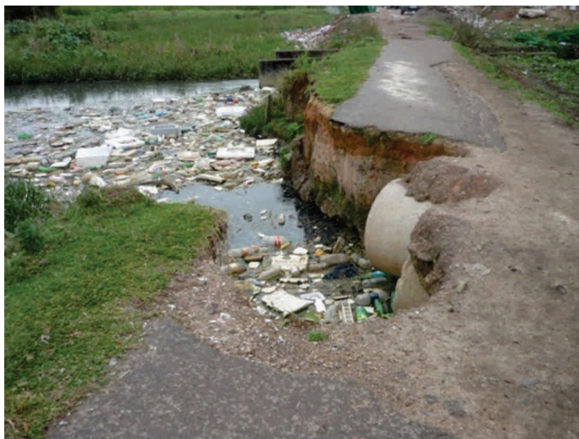
Figura 25: Lixo flutuante na tubulação entre as cavas do rio Iguaçu. Fonte: SMOP-OPO, 2015.
