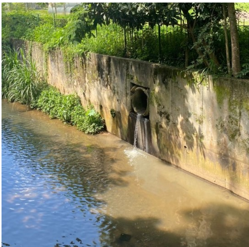
Figura 27: Lançamento irregular de esgoto sanitário – Detecção de efluente com coloração acinzentada e aspecto gorduroso característico de esgoto em galeria de águas pluviais – Rio Belém, região do Bosque do Papa.
