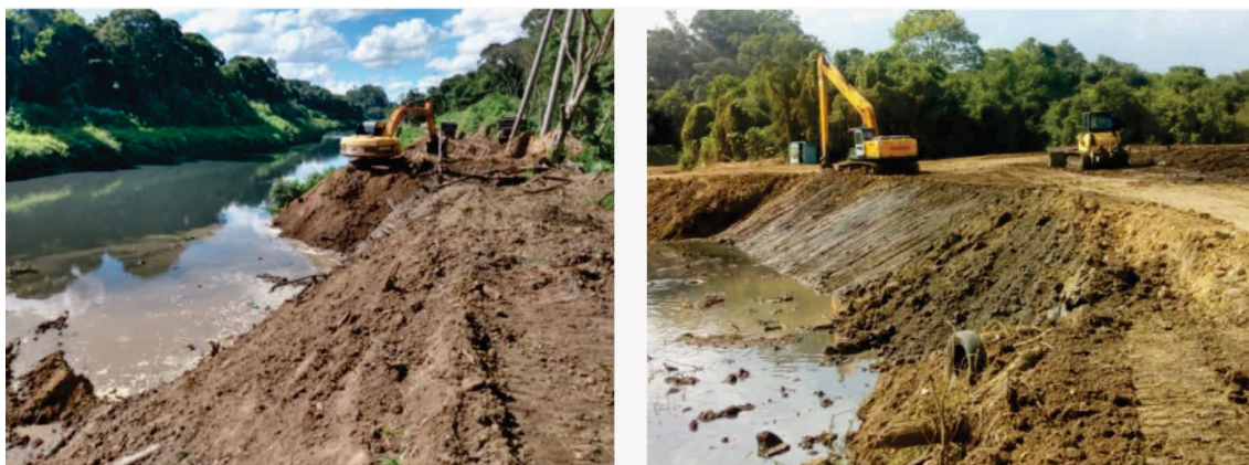
Figura 14: Rio Barigui no trecho a jusante da rodovia do Xisto. Fonte: SMOP-OPO, 2023.
