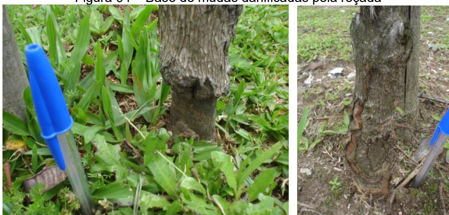
Figura 94 – Base de mudas danificadas pela roçada
