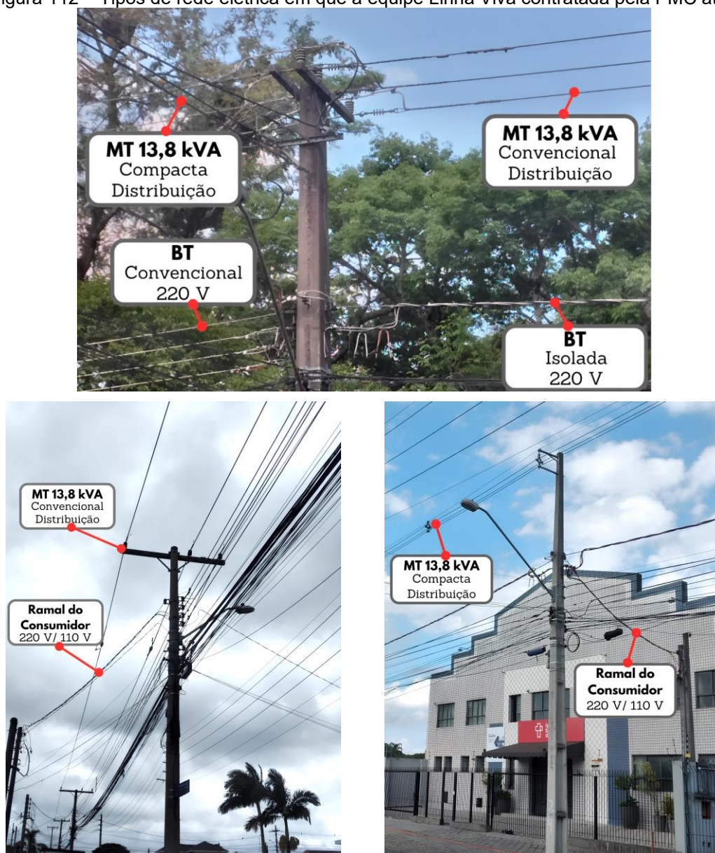
Figura 112 – Tipos de rede elétrica em que a equipe Linha Viva contratada pela PMC atua
